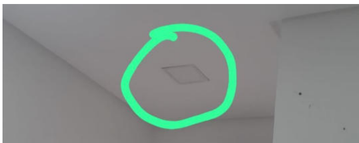
Luminária - Corredor das Salas
