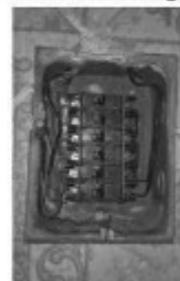
Quadro de energia
